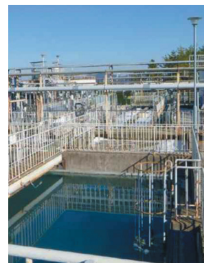
アクアセンターで浄化された後の工場排水
