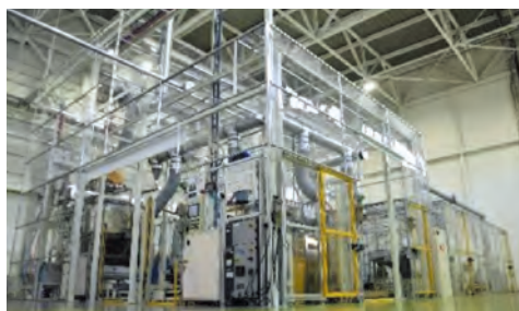
バイオガス 実証プラント
